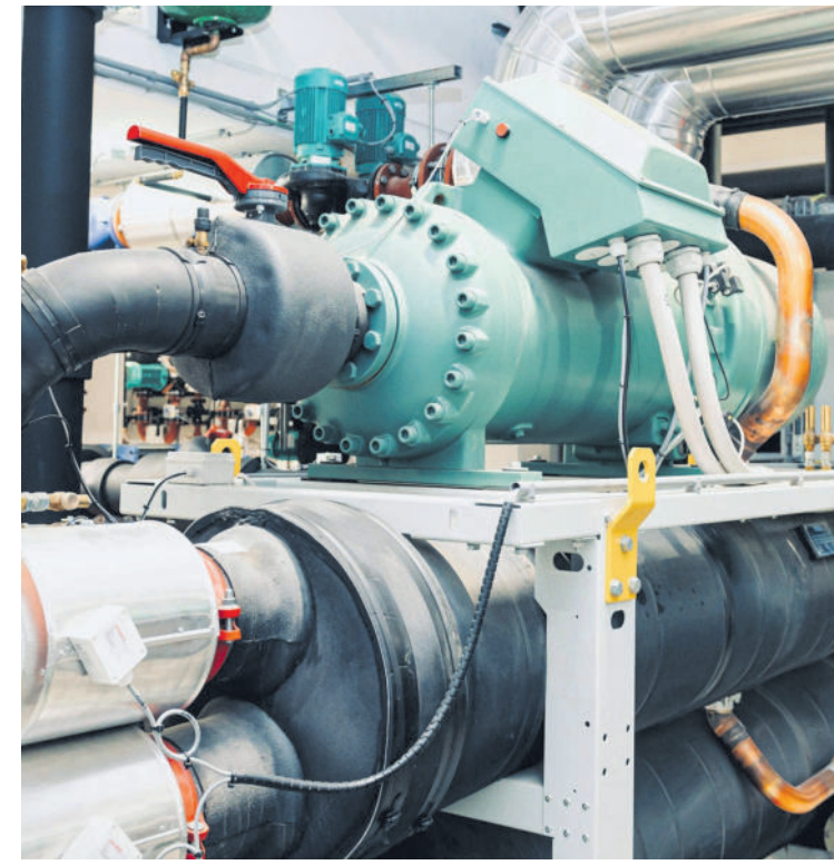
▲ Das (grüne) Herz. Der Wärmetauscher macht in einem hermetisch abgeriegelten System Heizen und Kühlen möglich.
